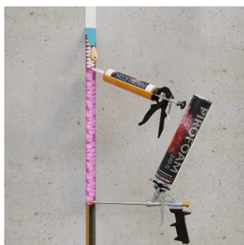
Pustą przestrzeń wypełnij Piro Foam 240 i nałóż warstwę PIROSILICON 240 po obu stronach ściany
